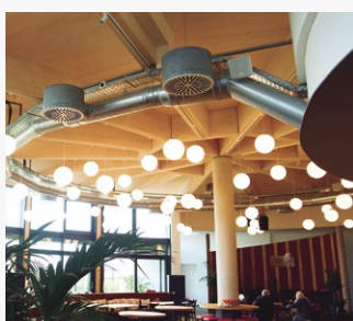
Мясная лавка Вайнбах. Магазин – Ресторан. Эпфинген. Германия. VRF, Бытовое и холодильное оборудование.
